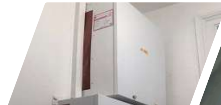
Fire ECU Unit
